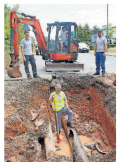
In der Berliner Straße in Erbach hat es am Mittwoch einen Wasserrohrbruch gegeben. Stadtwerke-Meister Klaus Cloß (im Graben) und seine Mitarbeiter begutachten hier den Schaden.
